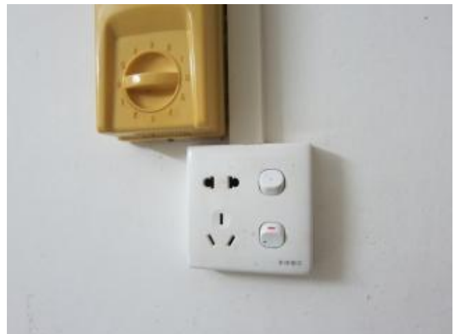
（部屋のコンセント。変圧器が必要ですがプラグは日本のものが使えます）
